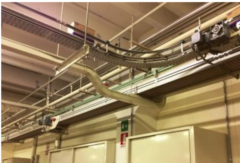
Figura 27 – Situazione impiantistica negli stabilimenti di produzione.
