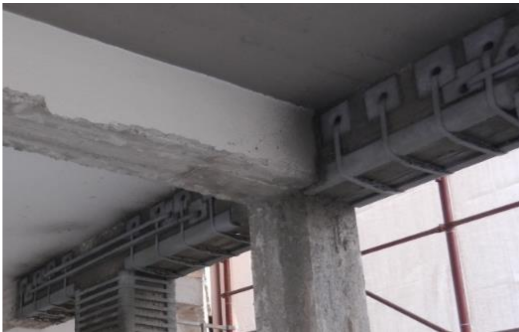
Figura 21 – Rinforzo della trave in parziale avvolgimento: in corrispondenza dell'intradosso trave sono disposti angolari, in corrispondenza del foro trave sono disposte delle piastre imbutite.
