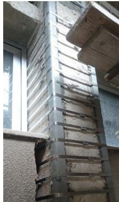
Figura 17 – Edil CAM SISTEMI: Pilastro in corrispondenza di infissi senza prevederne la rimozione
